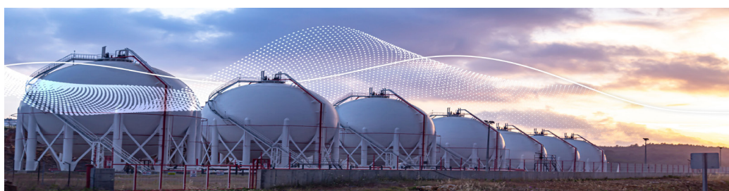
Figure 3. LNG spherical storage tank.
